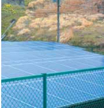
設置が進むソーラーパネル
