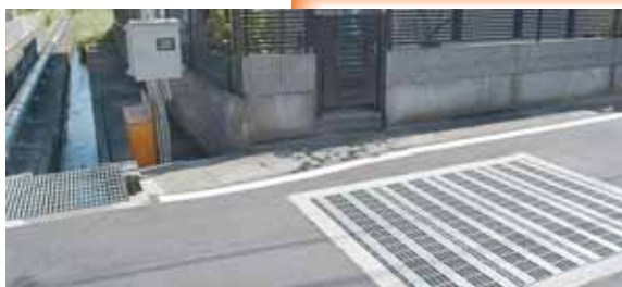
下名生 剣水地区の 排水ポンプ
