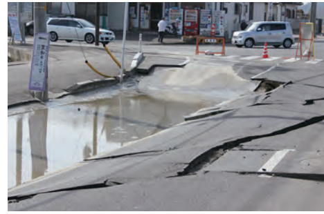
液状化現象により道路が陥没
