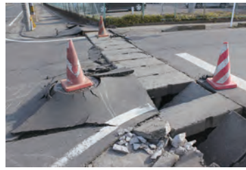
多くの下水道マンホールが隆起
