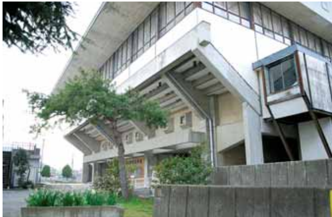
使用が中止された町民体育館
