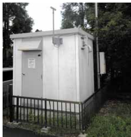
柴田町の設置場所：船岡西地区
