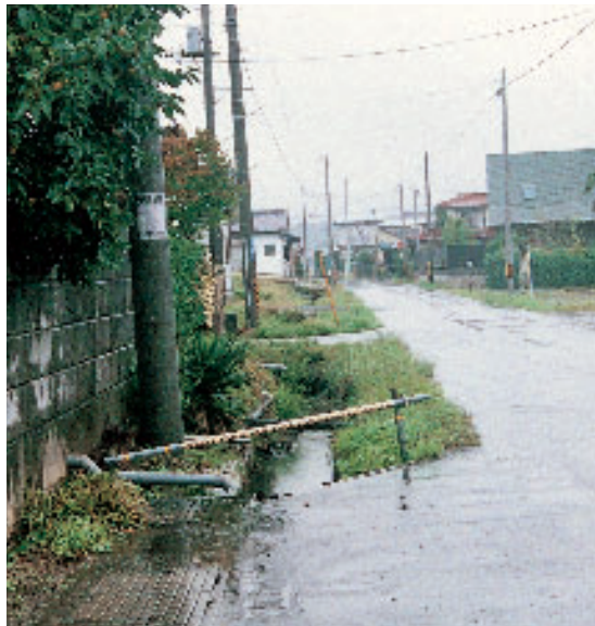
整備が必要な側溝
